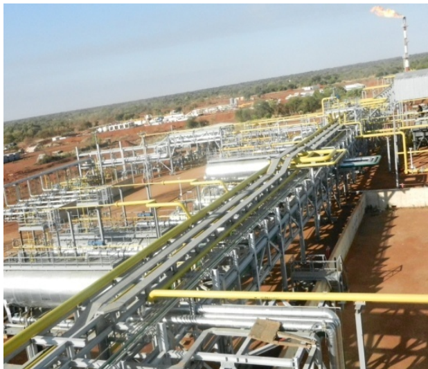
B区Keyi油田地面油气处理站 (FPF) 操作运行及维修维护, 年产330万 桶
