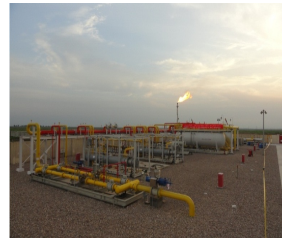
伊拉克哈法亚油田GRS（集气站）操作运行及维修维护
