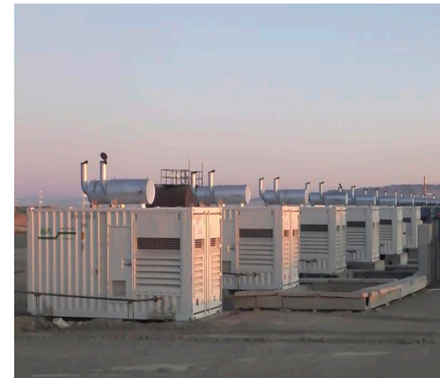
CNPC乍得Ronier油田增产期间, 提供一年期的租赁电力供应服务, 包括柴油发电机、输电设备和运维 人员服务, 电站容量5.4兆瓦, 电压 等级33KV。
