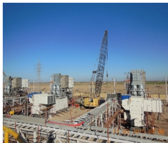
伊拉克哈法亚油田2个天然气发电厂操作运行及维修维护
