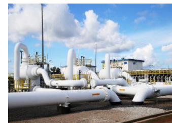
天然气运输设施
