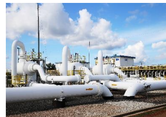
天然气运输设施
