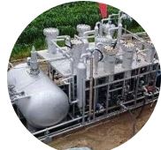
增压气举一体 压缩机
