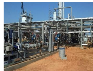
天然气处理场站
